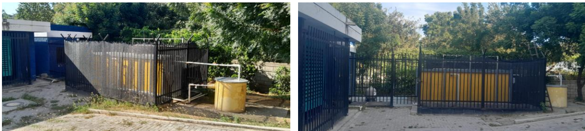
Planta de tratamiento de aguas residuales
