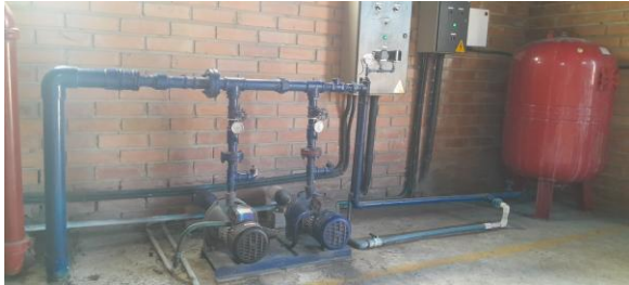
Red de electrobombas agua potable
